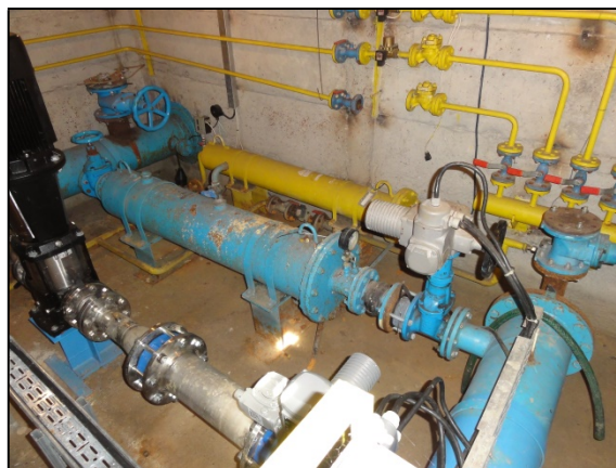
Régi EMU nyomásfokozó szivattyú
