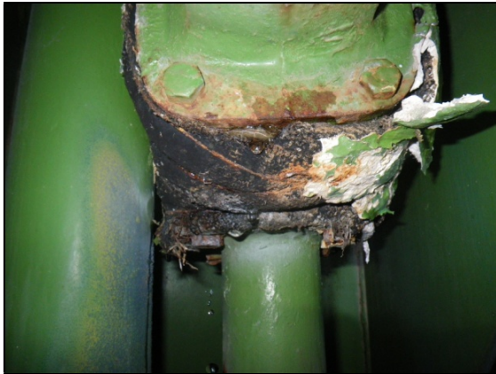
Töltő – ürítő vezeték leromlott állapot
