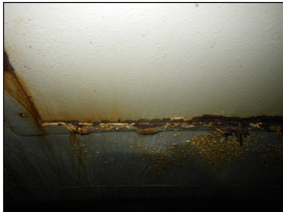
Víztér felületi korrózió
