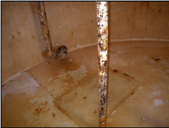
Víztér és szerelvény korrózió
