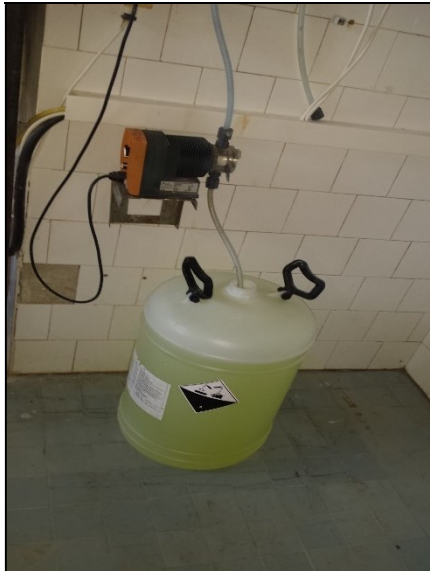
IV.sz. vízműtelep - Vízkezelés
