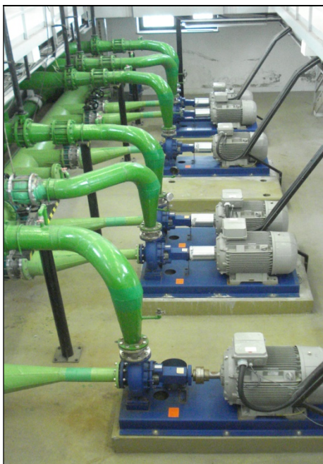
Orosháza Dózsa vízmű gépháza
