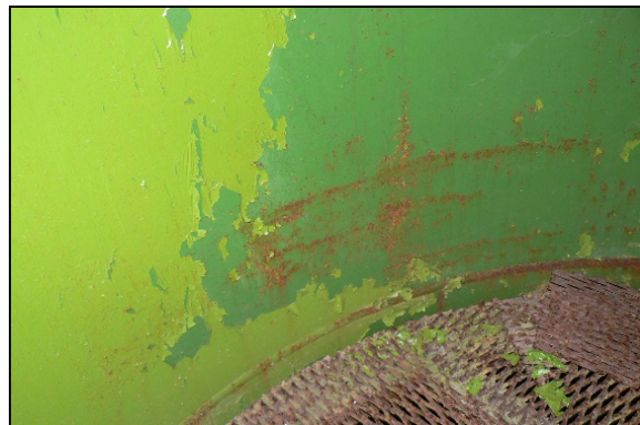
Felületi korrózió a víztorony belsejében
