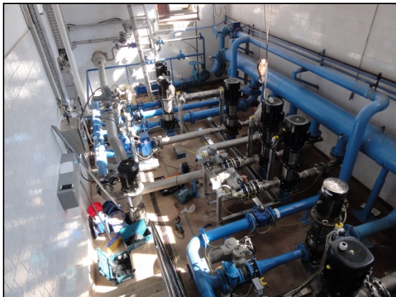
A nyomásfokozó gépház szivattyúi
