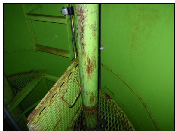
Víztorony töltő/ürítő vezeték
