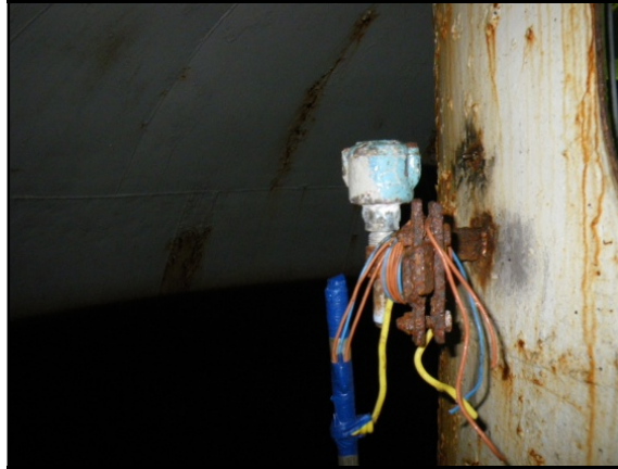
Felületi korrózió a víztorony belsejében
