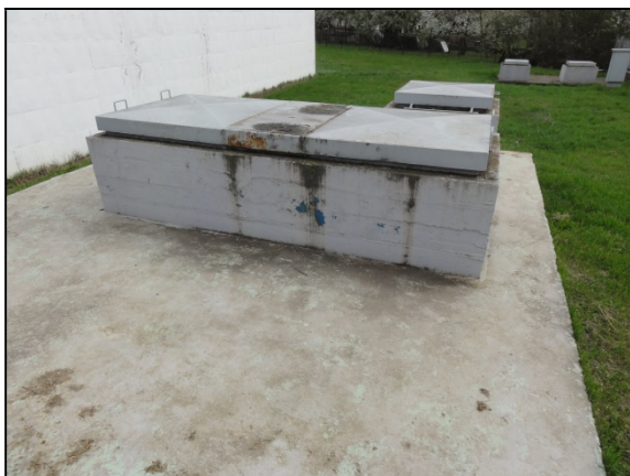
Nyomásfokozó akna lebúvó nyílás
