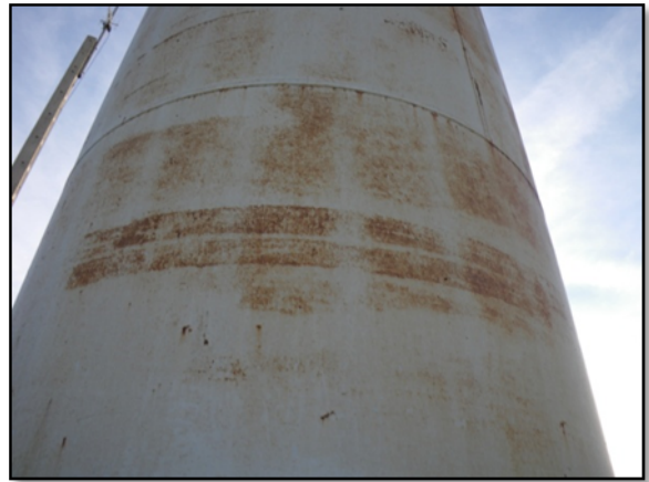
Toronyszáron található felületi korrózió
