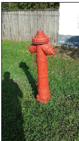
Földfeletti tűzcsap – Ady Endre út
