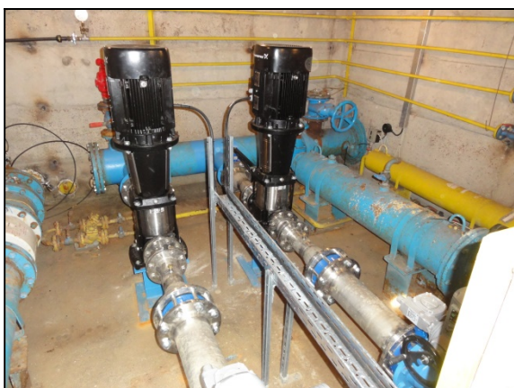
2 db új Grundfos szivattyú
