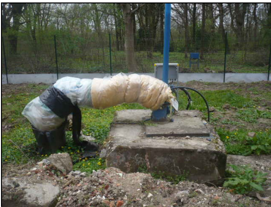
régi, üzemelő vízmű kút
