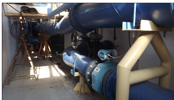
Átadási pont vandhádi gépház
