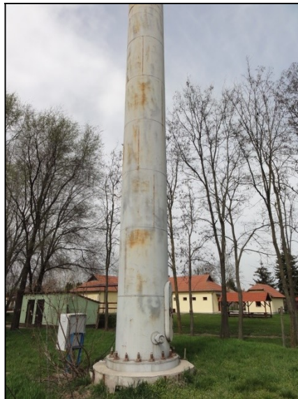
Toronyszár felületi korróziója
