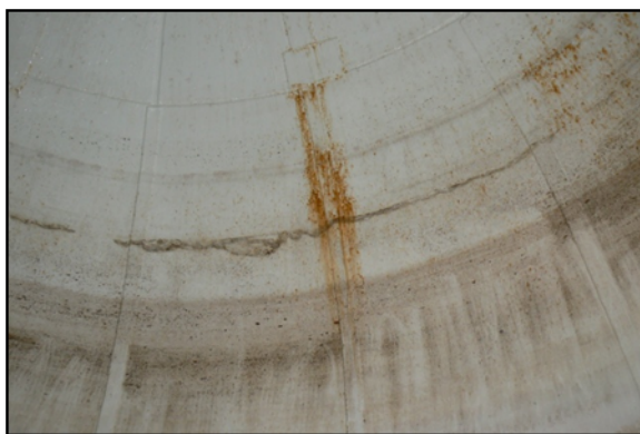
Víztér belső felületén lévő korrózió
