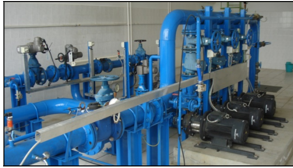
Dévaványa II. vízműtelep gépterem
