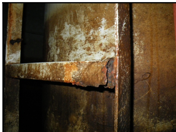
Víztorony szár korrózió
