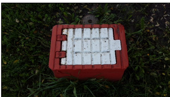
Földalatti tűzcsap Szénási út
