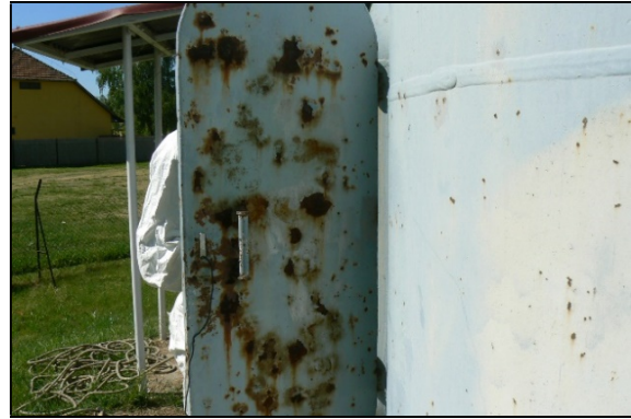
Felületi korrózió a toronyszáron
