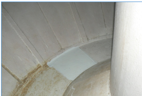
Víztéren belüli felületi korrózió
