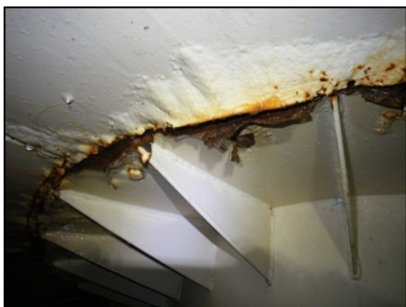
Víztér tartószerkezetének korróziója
