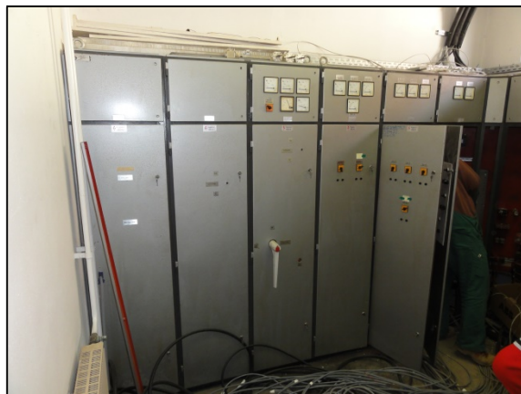
Újonnan kiépített irányítástechnikai rendszer
