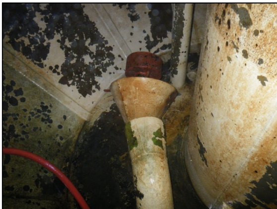
Túlfolyó és víztér
