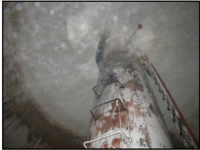
Víztéren belüli hágcsó
