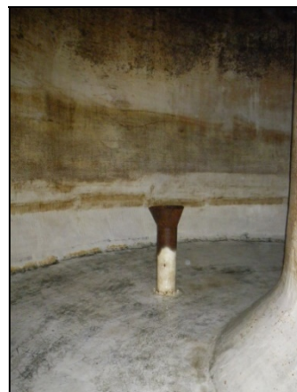
Víztéren belüli felületi korrózió
